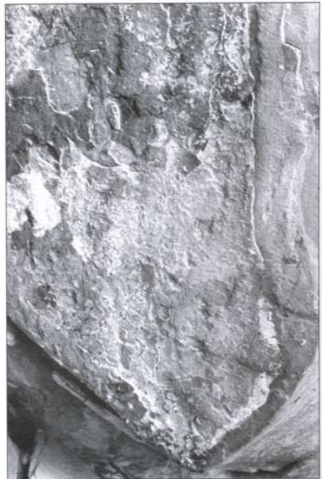
Foto 2.b: después de la limpieza.
