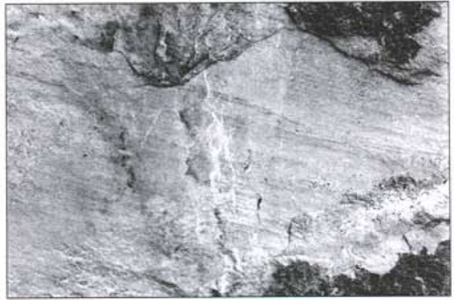
Foto 1.b: después de la limpieza.
